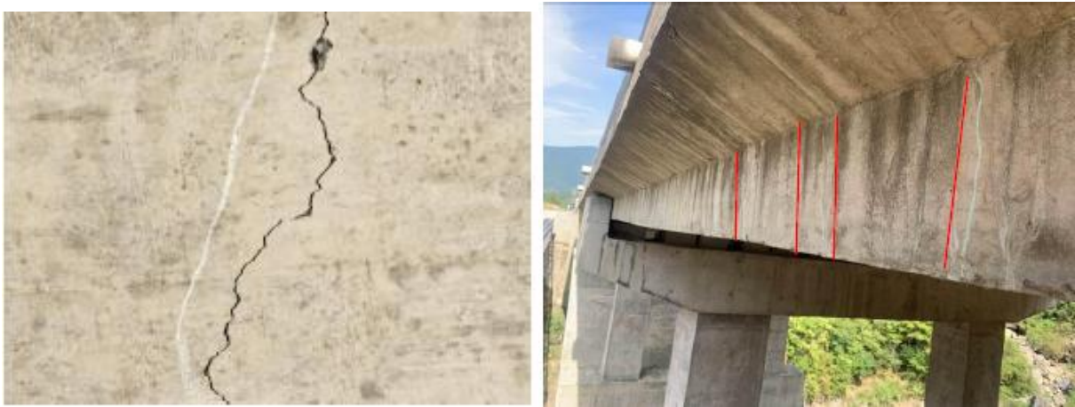
图 3.2-1 空心板裂缝照片
