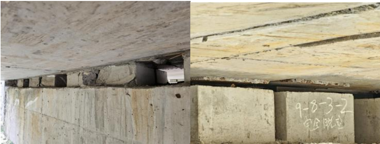
图 3.2-2 支座垫石破损
