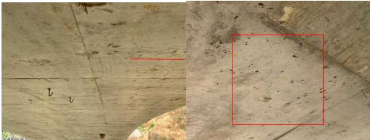
图 3.2-6 主拱圈横向裂缝
